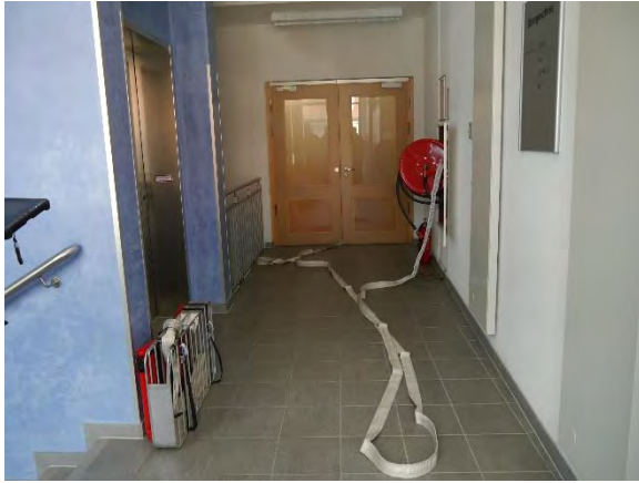
Abbildung 49 Der vorgehende Atemschutztrupp nutzt hier die vorhandene Löschwasserleitung des Gebäudes, um schneller zum Brandherd zu gelangen und nicht erst den Aufbau einer feuerwehrseitigen Löschwasserversorgung abwarten zu müssen. Dies erhöht signifikant die Überlebenschancen von Personen im Brandbereich.
