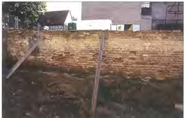
Abb. 7 Hanse- und Universitätsstadt Greifswald, Domstraße 23, Kellergeschoss, östliche Grenzmauer, Überblick von Westen. Die westliche und überwiegend im „Wendischen Verband“ errichtete Mauerschale der um 1300 aufgeführten Mauer war noch fast vollständig erhalten und zeigte wie die Mauerostseite keinerlei ursprüngliche Gliederungselemente. Im Bild links ist der auch bei Abb. 6 erkennbare nachträgliche Luftschutzdurchbruch zu sehen (durch eine Stütze teilweise verdeckt). Foto: A. Lutze (1995)
