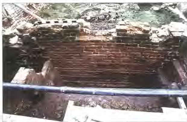
Abb. 12 Hanse- und Universitätsstadt Greifswald, Domstraße 23, Kellergeschoss, Vorderfassade, von Norden. Während die südliche Mauer- schale der ursprünglichen Vorderfassade durch jüngere Eingriffe fast vollständig überarbeitet bzw. abgetragen worden war, konnte auf der Mauernordseite noch im erheblichen Umfang ursprünglicher Mauerwerksbestand freigelegt werden. Dieser wurde links und rechts durch die Reste ursprünglich angelegter Kellerlichtschächte flankiert (im Bild direkt oberhalb der Leitungsführung). Foto: A. Lutze (1995)
