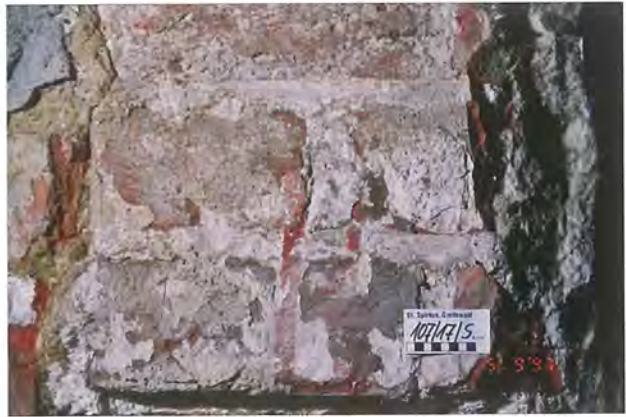
Abb. 4 Greifswald, St. Spiritus, Fugenstriche als Teil einer mutmaßlichen Quadermalerei. Foto: H.- H. Bär
