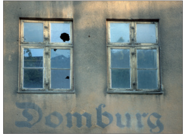
Abb. 3 Greifswald, Domstraße 21. Die Fenster der Straßenfassade mit festem Mittelstock und hoch gerücktem Kämpfer entstanden bei der Hausreparatur in den 1820er Jahren. Die Werbeinschrift stammt aus den 1930er Jahren. Foto: T. Rütz (1997)
