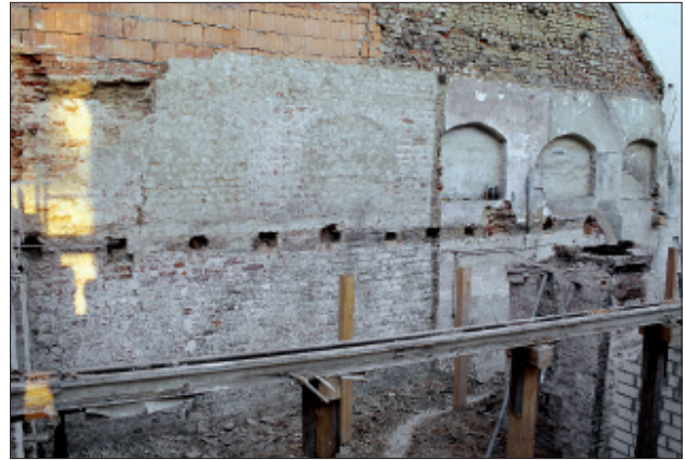
Abb. 2 Greifswald, Domstraße 21. Mittelalterliche Brandmauer zwischen den Grundstücken Domstraße 21 und 22. Die aus dem 15. Jahrhundert stammende Aufstockung mit den flachbogigen Nischen ist gut zu erkennen. Blick nach Südosten. Foto: T. Rütz (2002)
