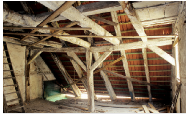
Abb. 10 Greifswald, Domstraße 21. Barocke Dachkonstruktion von 1722. Sie verfügte von Anfang an über einen doppelt stehenden Stuhl, dessen südliche Hälfte hier zu erkennen ist. Blick nach Süden. Foto: T. Rütz (2002)
