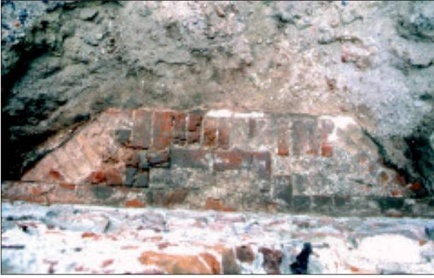
Abb. 10 Greifswald, ehemaliges Franziskanerkloster. Langhaus süd-mauer der Kirche nach der Freilegung. Polygonaler Halbpfeilersockel an der Mauernordseite (um/kurz nach 1300). Dieser ummantelt eine einfach gestufte Wandvorlage (hier die westliche) des ursprünglichen Langhauses (1290er Jahre). Aufsicht von Süden. Foto: A. Lutze (2001)
